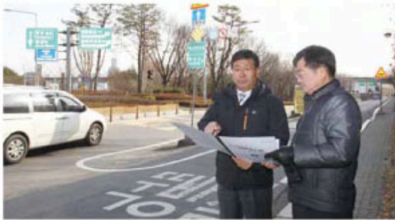
주민 동행 불편 해소를 위한 자양2동 잠실대교 북단 강변북로 진입로 분리대 공사 현장 방문(2014년 상반기 착공 예정)
